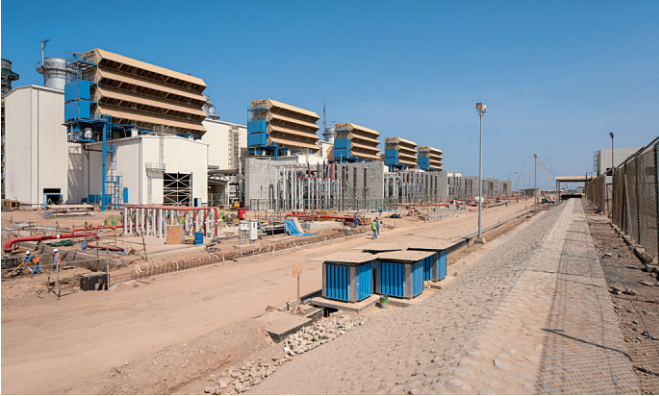
Bild 2 Block Nr. 3 mit 400 MW (links) sowie Block Nr. 2 (2 × Mitte) und Block Nr. 1 (2 × rechts) mit je 800 MW Block no. 3 with 400 MW (left) as well as block no. 2 (2 × center) and block no. 1 (2 × right) each with 800 MW
