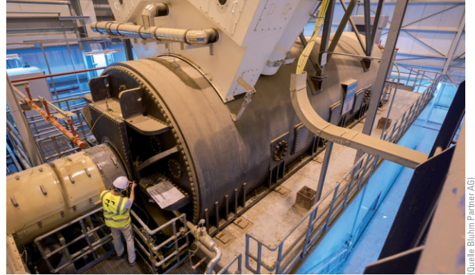
Bild 3 Generator vom Typ SGen5-2000H auf massivem Maschinenfundament; links im Bild schließt die Gasturbine an Generator of Typ SGen5-2000H on massive machine foundation; in the picture the gas turbine is connected to the left
